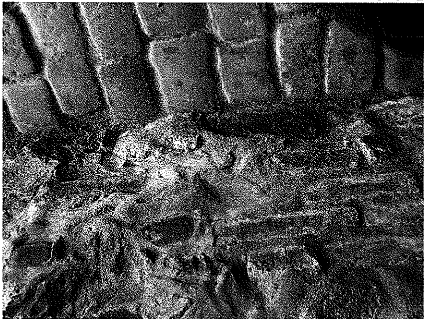
Fot.25 Silna zaprawa cementowa we wnętrzu bramy do ostrożnego usunięcia
