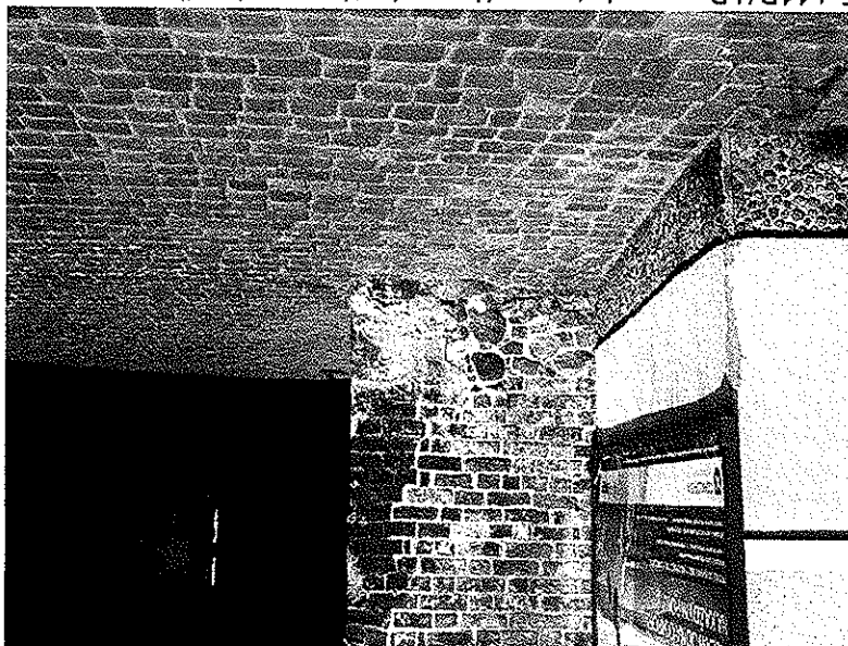
Fot. 11 Dół Bramy od strony północnej-włóżna spoina, liczne cementy do usunięcia
