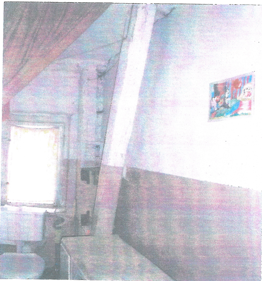
Klatka schodowa poziom 2-go piętra – poddasze. Wydzielone pomieszczenie sanitarne na schodach za pomocą kotar z materiału. Widoczna drewniana konstrukcja poddasza, bez żadnego zabezpieczenia p.poż. Pomieszczenie to nie odpowiada żadnym standardom pomieszczeń przeznaczonych nawet na czasowy pobyt ludzi.
