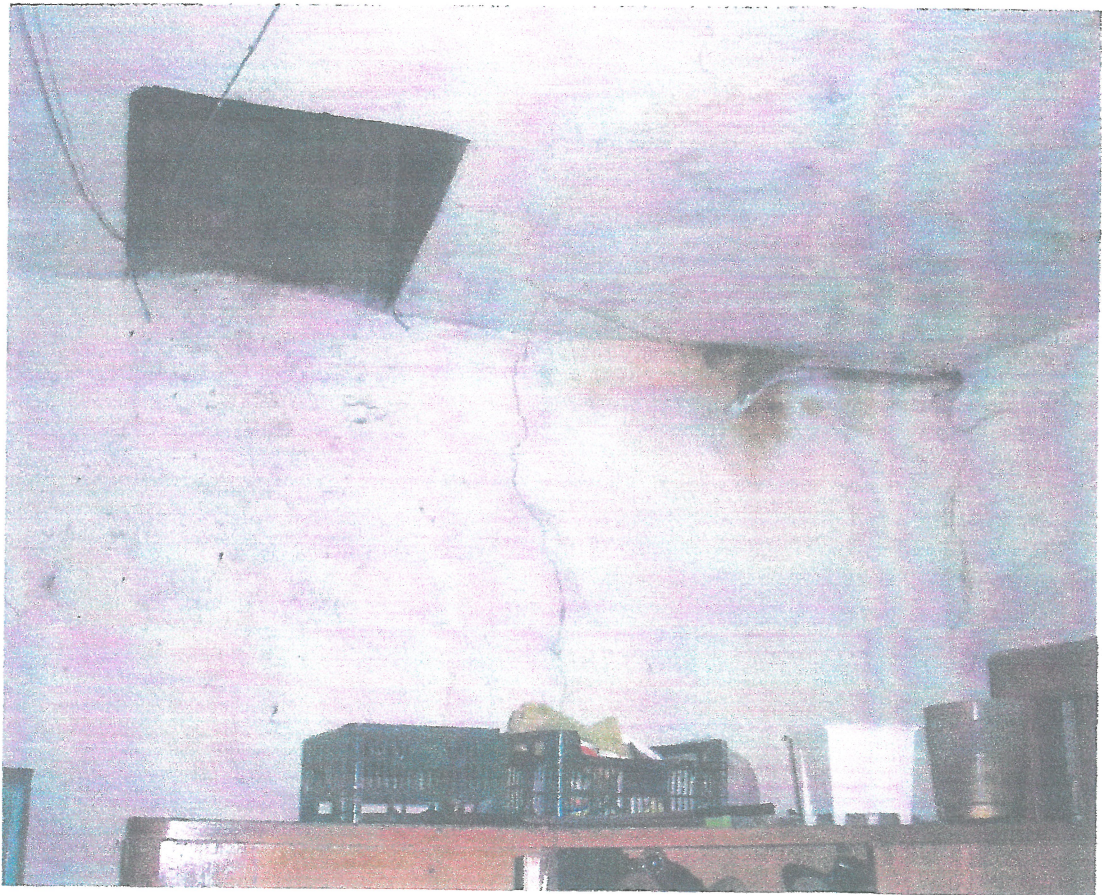
Poddasze – 2-gie piętro. Ślady przecieków przez stropodach świadczące o złym stanie tej przegrody budynku.
