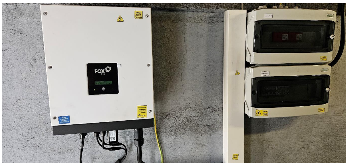
Zdjęcie 12. Inwerter instalacji PV wraz z osprzętem
