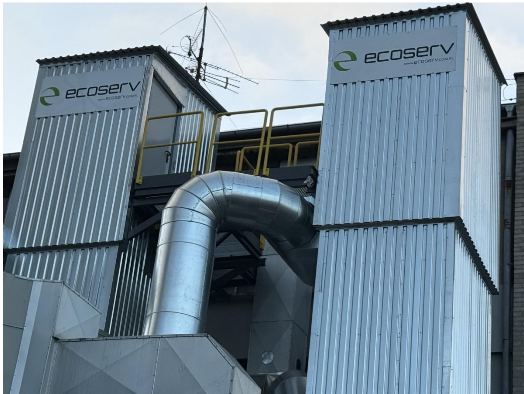
Zdjęcie 1. Modernizacja układu odpylania dla kotłów WR-4 nr 1 oraz WR-4 nr 2
