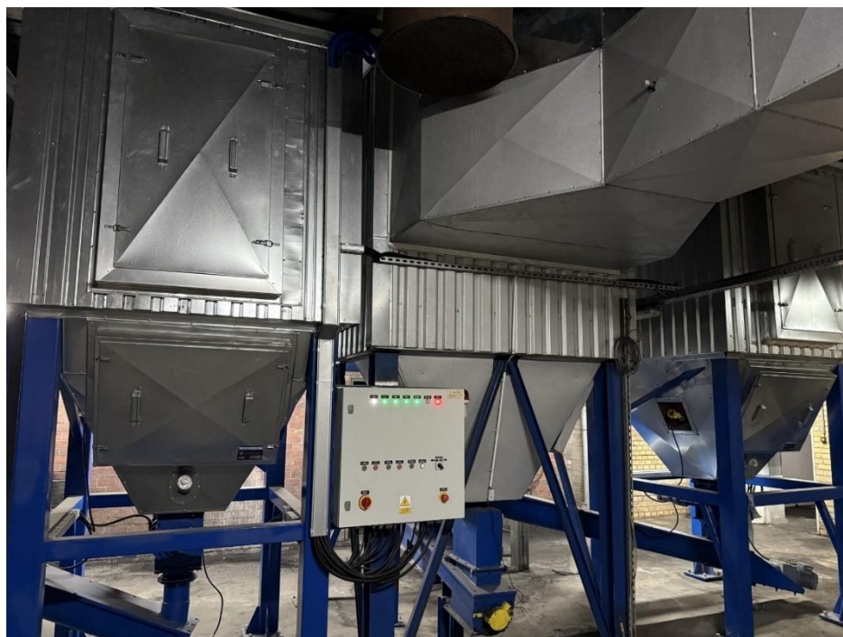
Zdjęcie 2. Modernizacja układu odpylania dla kotłów WR-4 nr 1 oraz WR-4 nr 2
